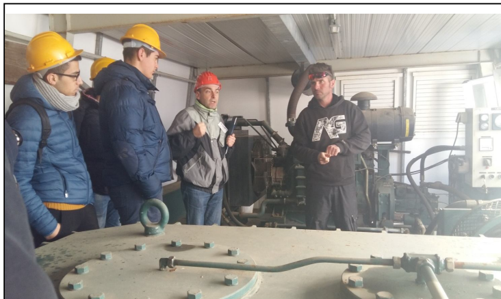
Fig. 8 - Spiegazione tecnica sugli apparati motori, principale e di riserva, nel locale macchine dell'impianto della seggiovia.
